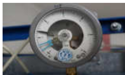
Рисунок №8 - Электроконтактный манометр парогенератор.
